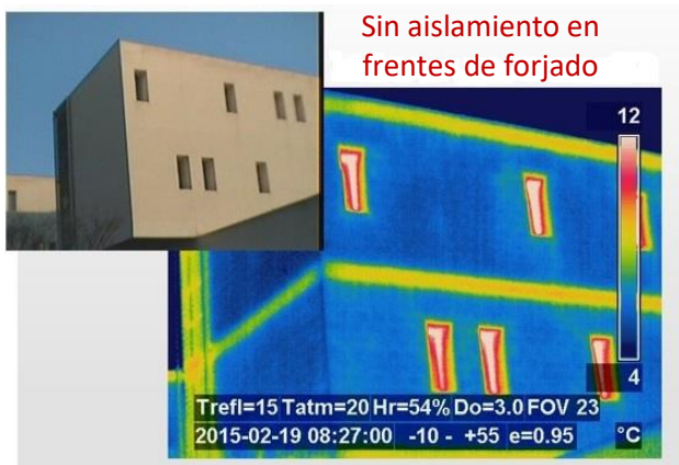
Fig. 6: Puentes térmicos en el edificio 1. Fuente: Autor.
