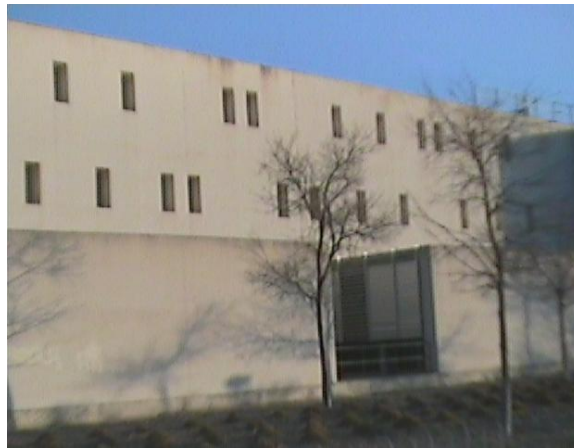
Fig. 4: Edificio 1: sin aislamiento térmico en los frentes de forjado.
